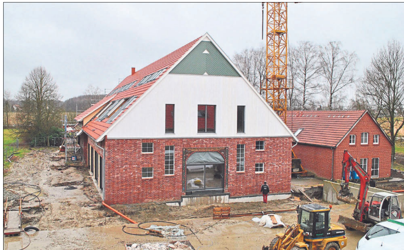
Die Wohnanlage Gut Wittenbach an der Deppendorfer Straße geht der Fertigstellung entgegen. Erhalten ist von der alten Substanz des Haupthauses – auf dem Torbogen wird Baujahr 1938 genannt – und der anderen Gebäude alles, was erhalten werden konnte. Fotos: Zeiger
